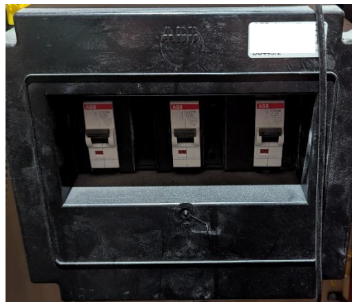
Figuur 3: Een hoofdzekering met verzegeling, met drie schakelaautomaten. Beeld: Marten Witkamp
